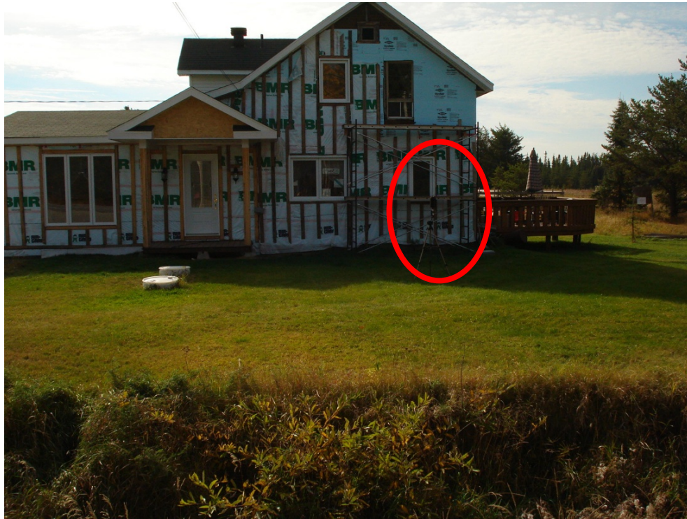
Photo 9 Installation de la station de mesures au point P5
