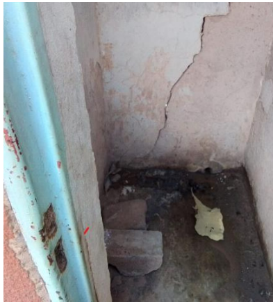
CS Moussodougou Intérieur d'une cabine de douche
