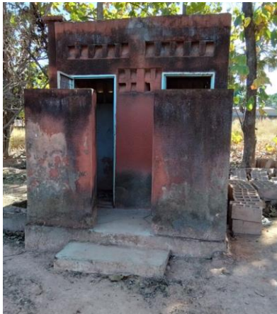
CS Moussodougou Etat du bloc de douche
