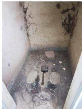
Cs Foukoura sans carreaux mal entretenu
