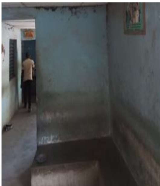
Mur dégradé CS Foukoura
