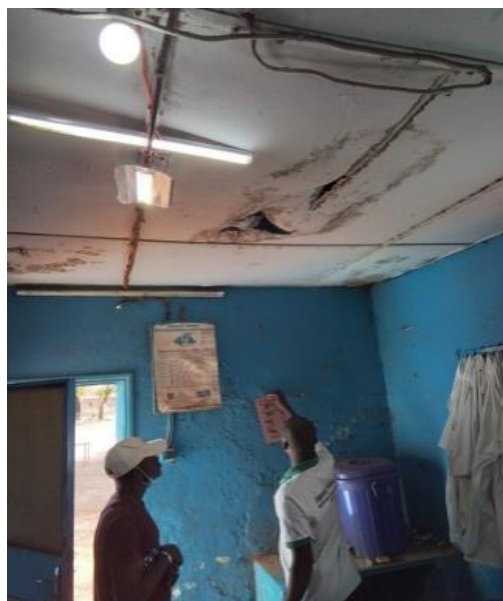
Mur et plafond dégradé CS Zegnédoudou
