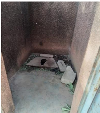
Latrines CS Ouléni sans carreaux mal entretenu
