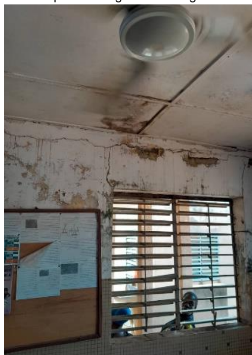
Fissure et humidité au niveau du mur et des plafond CMU Banfora.
