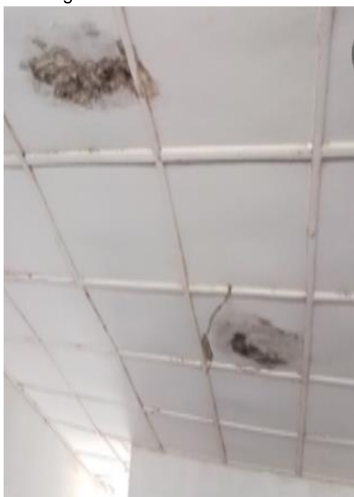
Auréole d'humidité au plafond CPS Gouindougouba
