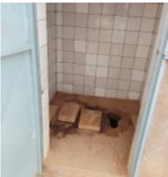
CS Nafona : Cabine de latrines VIP Double fausse relativement entretenu
