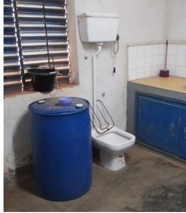
Photo 8 CSPS Tiekouna2 Vidoir accompagné de fut servant de réservoir d'eau
