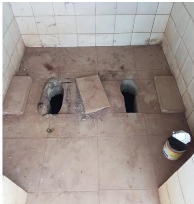
Photo 3 : Mauvaise utilisation des latrines (les deux fosses de la latrines sont ouvertes) au CS Zégnédougou
