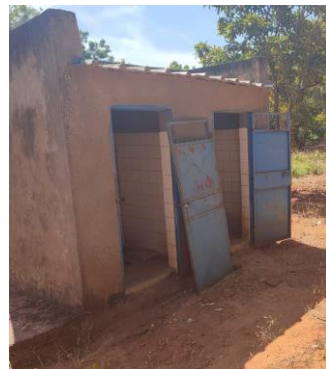
CS Kankalaba; état du bloc de latrines
