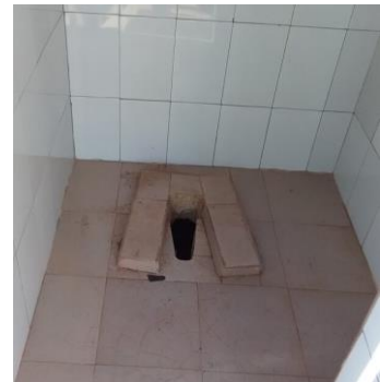
CS Kankalaba; Latrine avec carreaux mal entretenue
