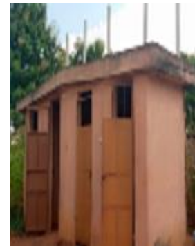
Adrogbo (bloc de latrine à réhabiliter
