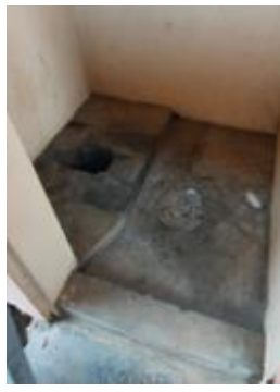
Cabine par Grand-Popo cabine à réhabiliter
