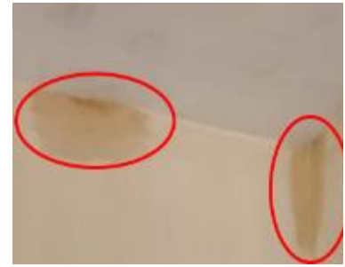
Photo 10: Marque d'humidité au niveau de la dalle CS Adrogbo
