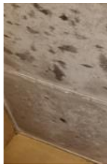
Photo 9: Faux plafonds imbibés par l'eau et attaqué par les moisissures HZ Lokossa
