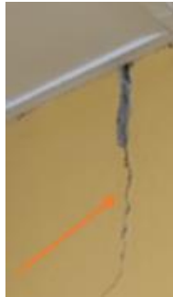
Photo 8: Fissure dans le mur CS Doutou
