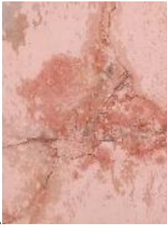
Photo 7: Fissure dans le mur et infiltration d'eau maternité Adrogbo
