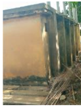
Bloc de latrines à reconstruire à Lokossa
