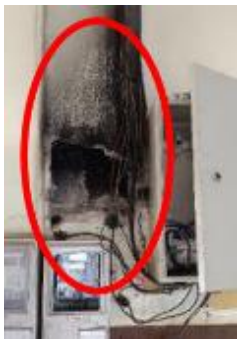
Photo 11: Compteur électrique ayant pris feu dans la maternité de l'HZ Lokossa
