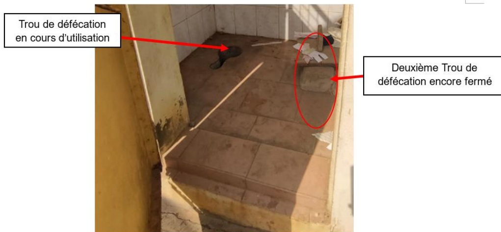
Photo 15 ; intérieur de latrine VIP double fosse avec le deuxième trou de défécation encore fermé à Atchannou. Source : PLURIELLES juillet 2023 et janvier 2024
