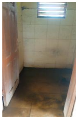
Intérieur cabine de douche avec tuyau d'évacuation bouché
