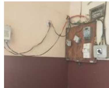
Photo 14: Boîtiers de disjoncteur non sécurisé et filerie apparente CS Doutou
