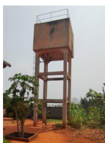
Réservoir d'eau de l'adduction d'eau du village dans l'enceinte du CS Adrogbo
