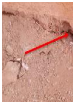
Photo 12: Érosion pluviale au tour du bâtiment de la maternité Adrogbo
