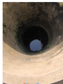
Puits non utilisés resté ouvert
