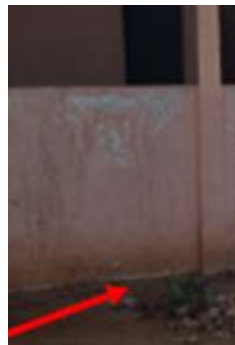
Photo 13: érosion pluviale au tour du bâtiment de la maternité Adrogbo
