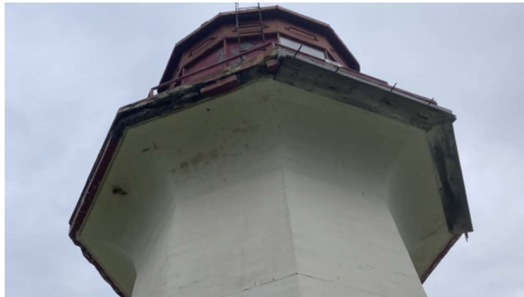
Photographie 3 : Couronne de béton à réparer
