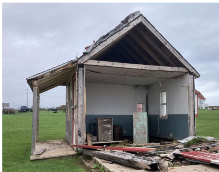
Photographie 4 : Cabanon endommagé par les vents à démanteler
