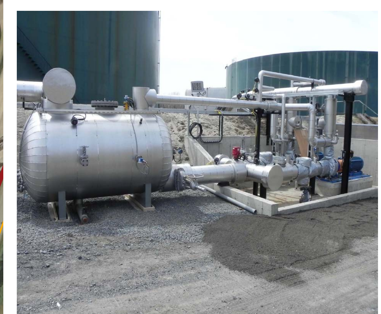
Système de déchargement par gravité vers la station de pompage afin de transférer le produit des wagons vers les réservoirs d'entreposage
