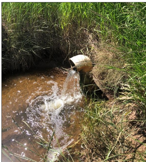
Photo 2. Écoulement de la structure de contrôle des eaux.
