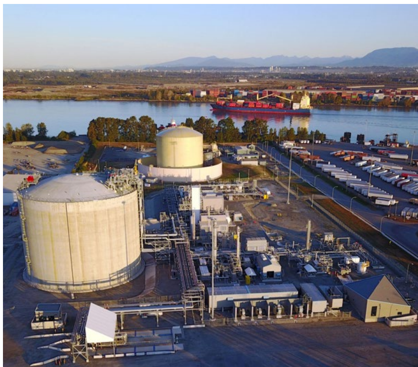
Figure 3-1. Vue de l'installation Tilbury avec la phase 1A à l'avant-plan et le réservoir d'origine à l'arrière-plan
