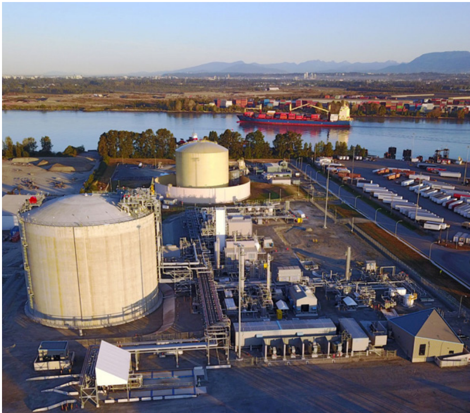
Photo 1: Vue de l'installation de Tilbury avec le nouveau réservoir de stockage à l'avant-plan et le réservoir d'origine à l'arrière-plan.
