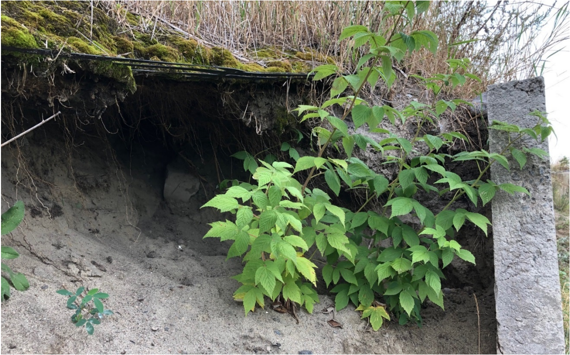
Photo 16 - Décrochage de la paroi nord de l'ancien nichoir (21-08-2019)
