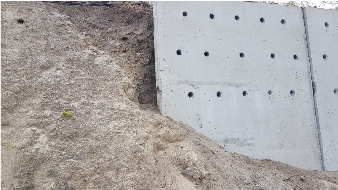
Photo 14 - Érosion derrière le muret de béton du nouveau nichoir (16-08-2019)
