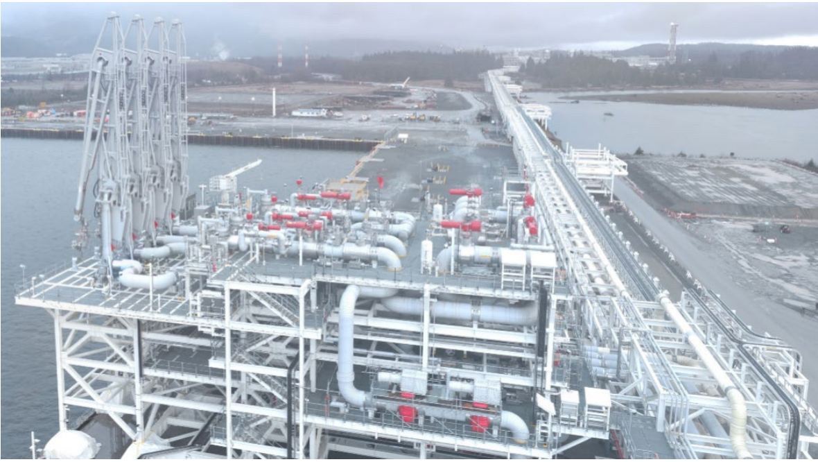
PHOTO 3: LNG LOADING MODULE AND ARMS (MARCH 2025)
