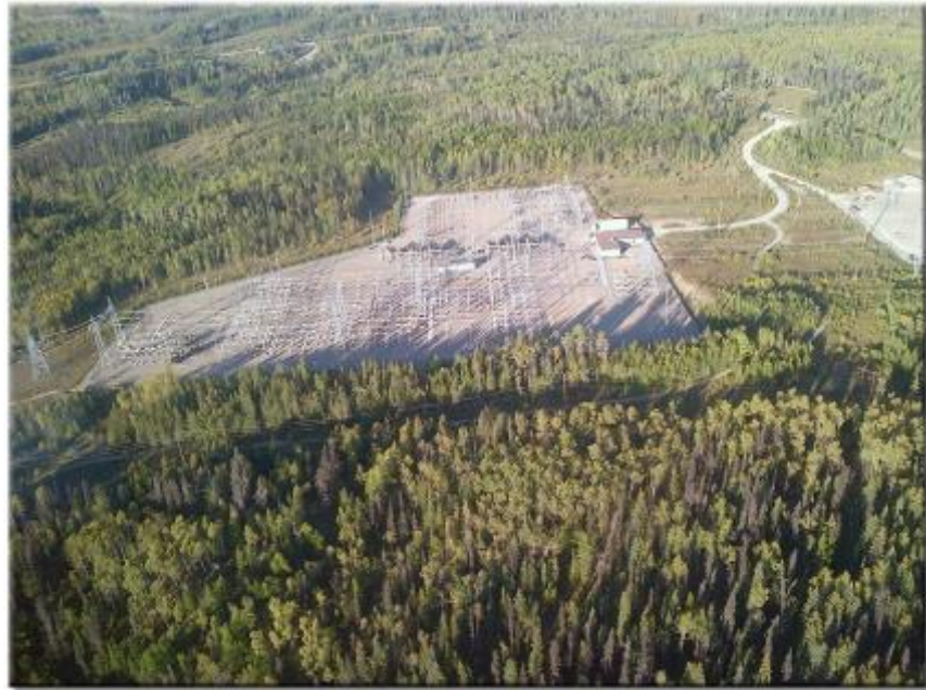
Photo ES 2 : Vue aérienne de la sous-station de BC Hydro, au sud d'Endako
